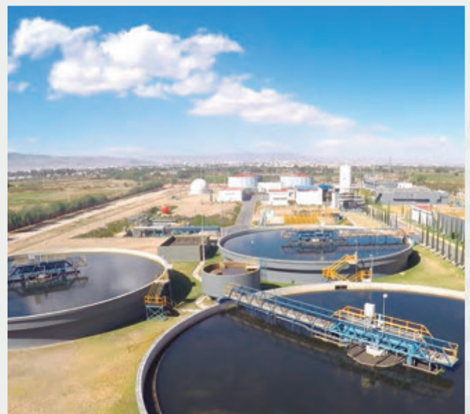
Planta de tratamiento de aguas residuales y Tanque Tenorio.
